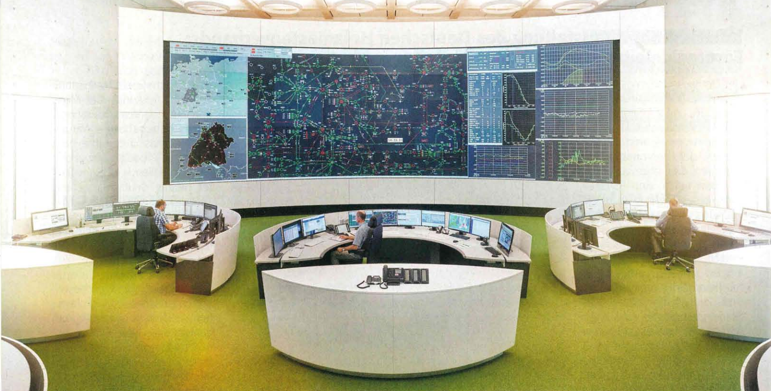
Bild 1. Die Hauptschaltleitung in Wendlingen
